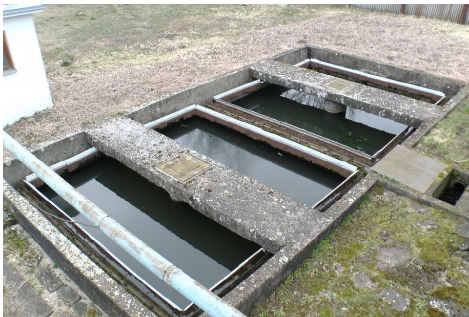
Snímek 7. Dosazovací nádrž
