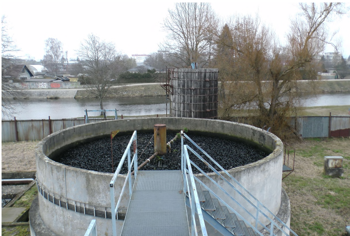
Snímek 2. Biologické filtry, oplocení východního okraje areálu a tok Vltavy
