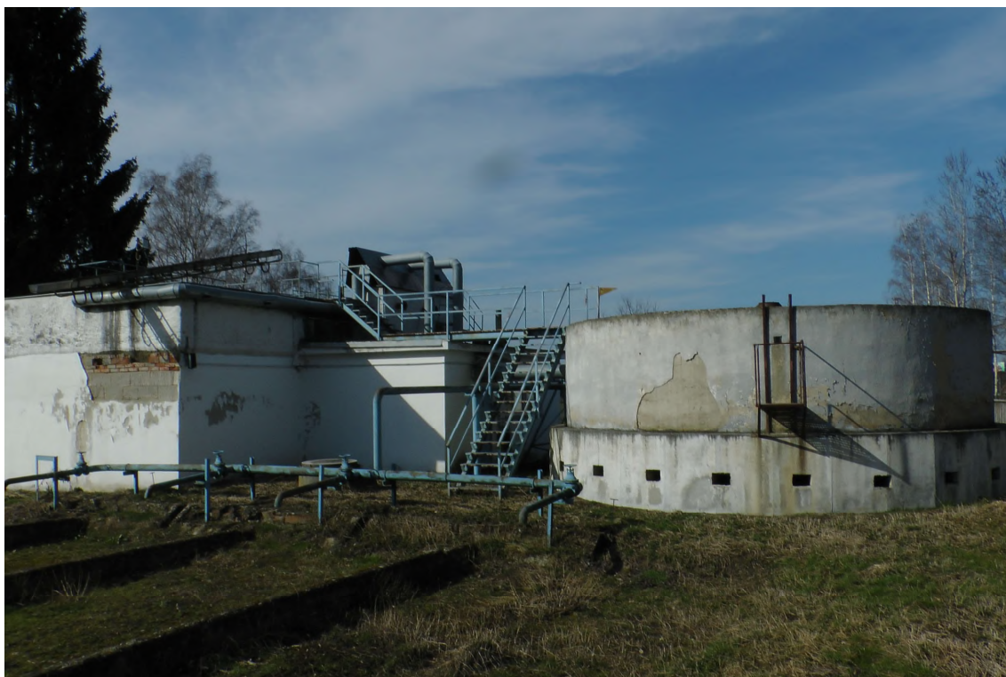
Snímek 11. Vlevo šterbinová nádrž, vpravo biologický filtr a před nimi kalová pole
